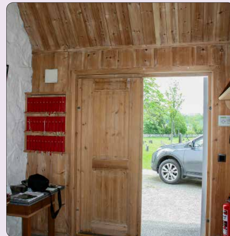
Panelet i tak og vegger har mørknet mye og virker skjoldete.
